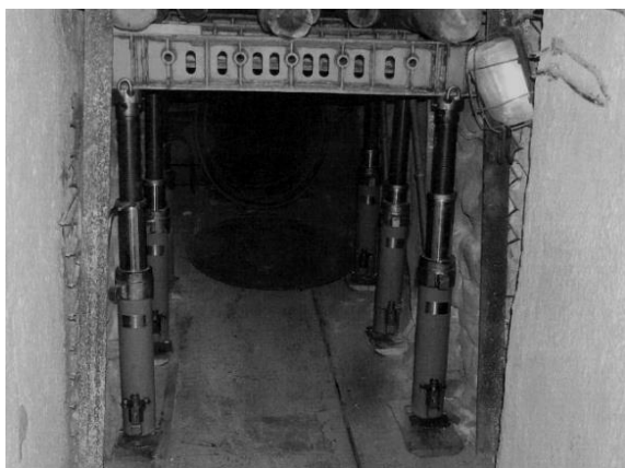
Rys. 6. Obudowa chodnikowa typu KR-7,8 zabudowana w chodniku [8]
